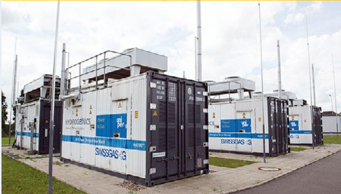
Abb. 21: Elektrolyseanlage in Falkenhagen, Foto: Uniper
