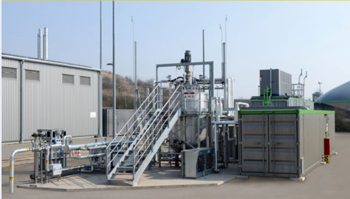
Abb. 22: Power-to-Gas-Anlage mit Biologischer Methanisierung, Anlage Allendorf (Eder); Viessmann Werke
